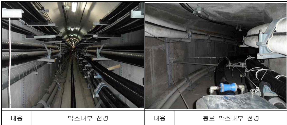
【사진 1.1】 구리인출 전력구 현황
