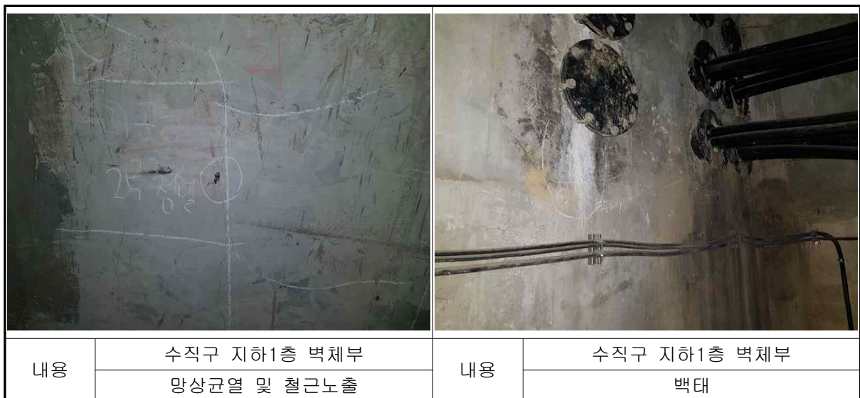
【사진 1.3】 구리인출 전력구 수직구 손상현황
